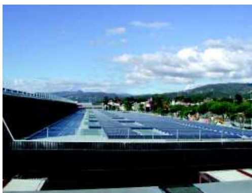
Figura 2 – Esempio di installazione idonea alla classificazione dell'impianto fotovoltaico nella categoria "su edifici" in caso assenza di una balaustra perimetrale
