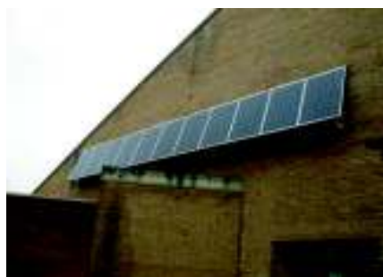
Figura 25 - Esempio di installazione non idonea alla classificazione dell’impianto fotovoltaico nella categoria “su edifici” – Motivazione: la struttura collegata non sottende superfici trasparenti
