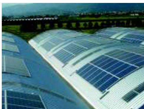
Fig.15 – Esempio di installazione idonea alla classificazione dell'impianto fotovoltaico nella categoria "su edifici" in caso di installazione su una superficie di copertura curva
