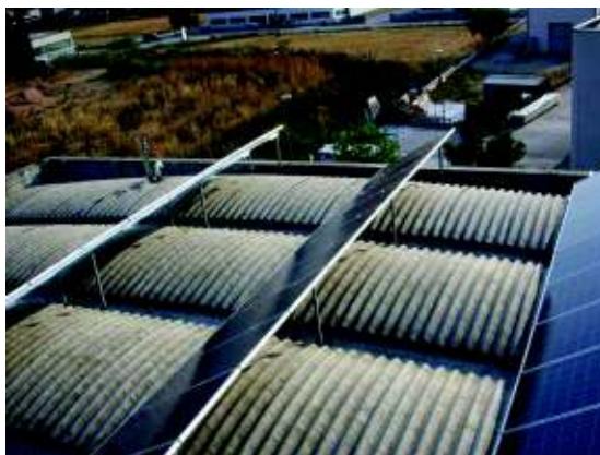
Figura 16 - Esempio di installazione non idonea alla classificazione dell'impianto fotovoltaico nella categoria "su edifici" – Motivazione: i moduli non sono disposti secondo il piano tangente
